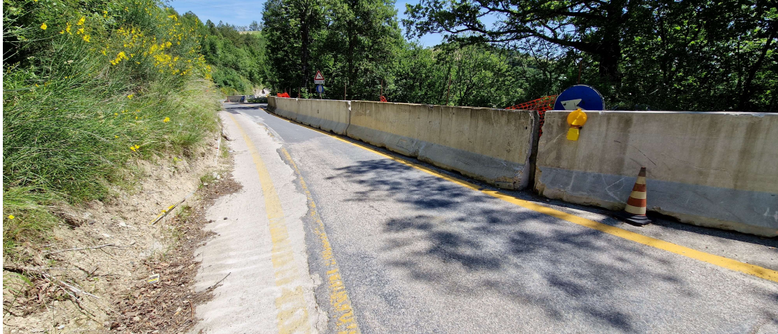
Figura 6: Riduzione carreggiata causa frana al km 0+200
