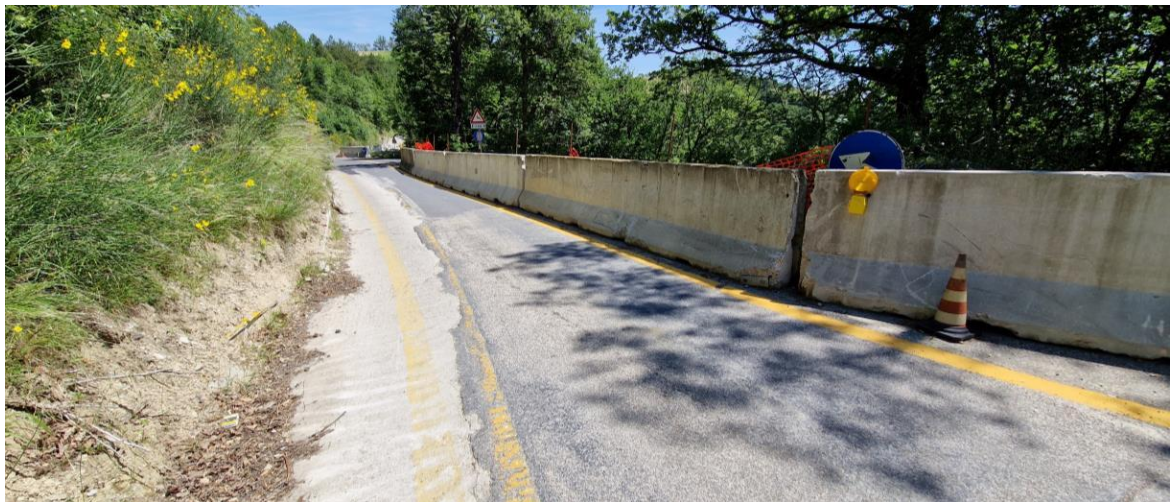
Figura 21: Foto 2: Riduzione carreggiata causa frana al km 0+200
