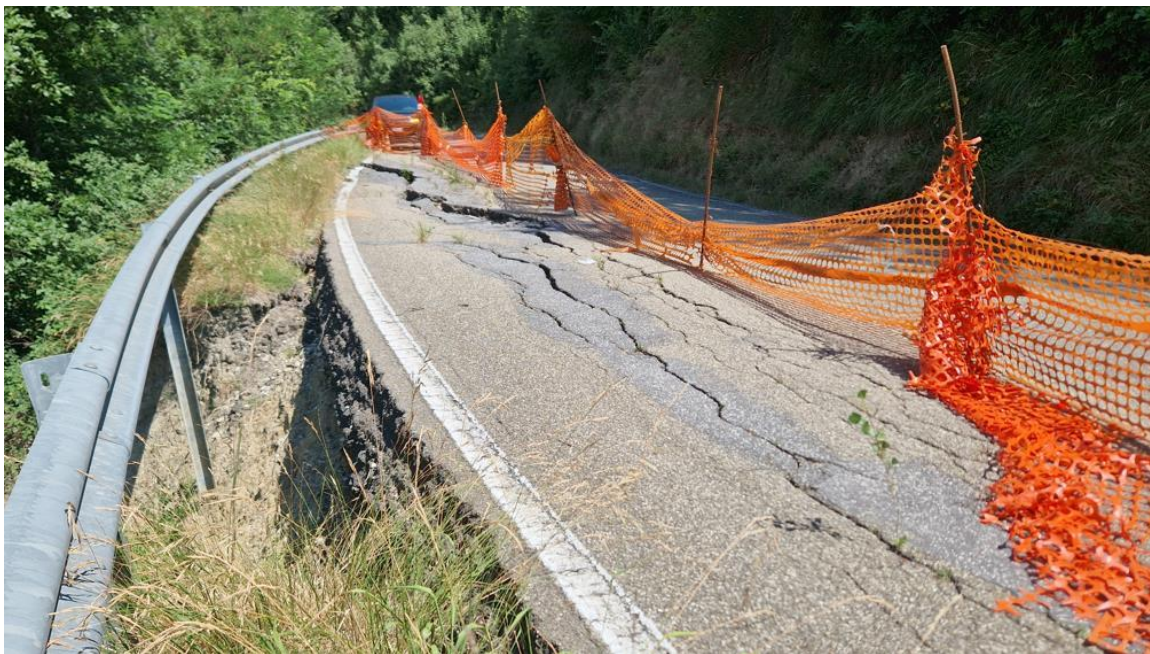
Figura 26r: Particolare del crollo della scarpata della strada al km 3+100
