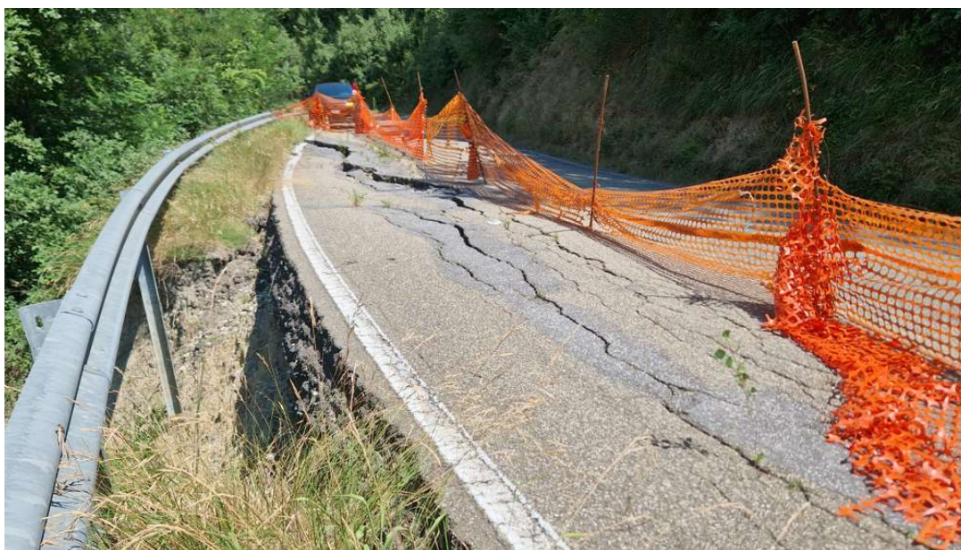
Figura 8 quater: Particolare del crollo della scarpata della strada al km 3+100
